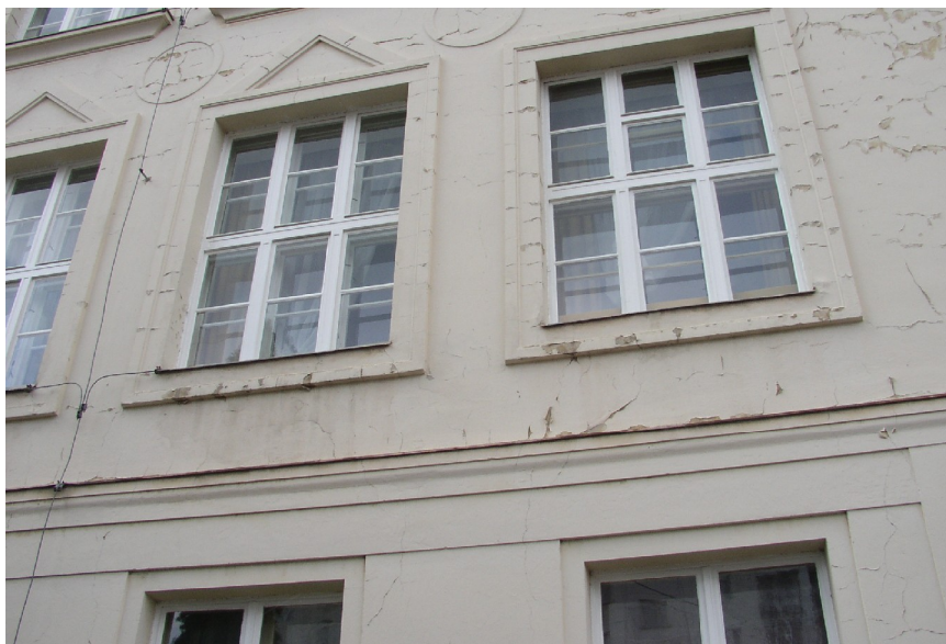
Zvetralá fasáda školy, drevené okná
