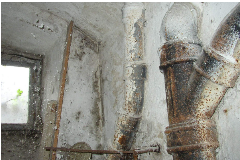
Netesnosti na hrdlách liatinových stupačiek, praskliny na liat.kanaliz. rúrach vlhký suterén
