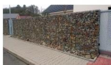
VYSOKÝ GABIONOVÝ PLOT / Nežiaduci
